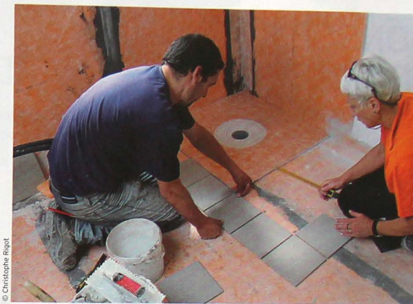
Former tous les professionnels aux spécificités de l'ossature bois : c'est le pari de Bois PE. Ici, un stage pour les carreleurs.
